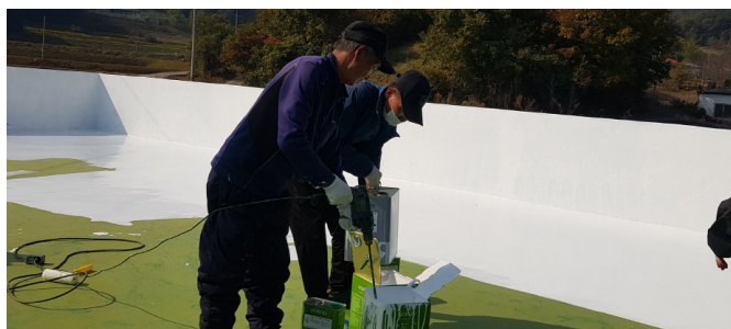
気候危機安心村(舒川郡サンドン里)へのクールルーフ施工(施工前 24.1℃ → 後 14.1℃)
