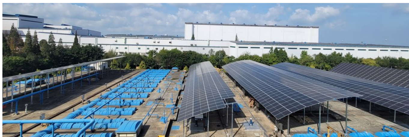
唐津市古袋・富谷公共下水処理施設への新再生可能エネルギー(太陽光)設備の設置
